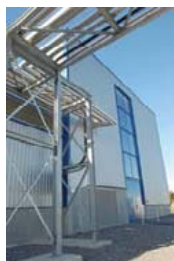
La vapeur rejoint le site de fabrication grâce à ce système de tuyaux aériques.
